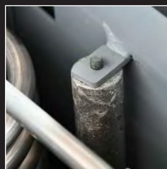
Anode sacrificielle en magnésium pour une meilleure protection de la chaudière
