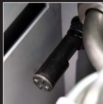
Wasser-Füllstandanzeiger zur Kontrolle des Wasserstands im Heizkessel
