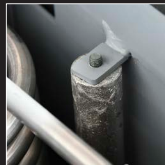
Magnesium-Schutzanode zum Schutz des Heizkessels
