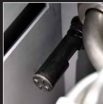
Wasser-Füllstandanzeiger zur Kontrolle des Wasserstands im Heizkessel
